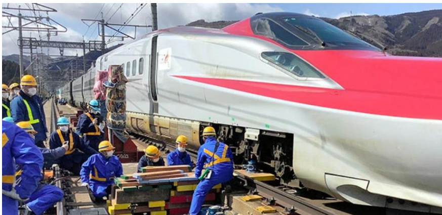
Año 2011 restauración de la línea Tohoku Shinkansen que fue gravemente afectada por un terremoto de magnitud 9.0 (Richter) en tan solo 49 días.
